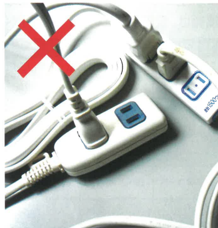
テーブルタップの 接ぎ足し連続使用はしない
